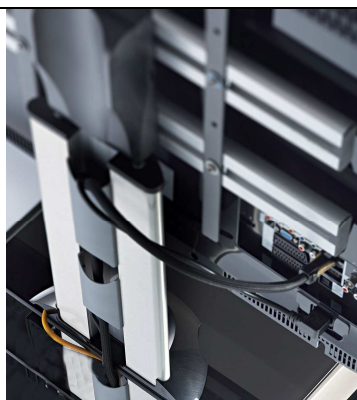
Detailansicht: Kabelführung Rückseite
